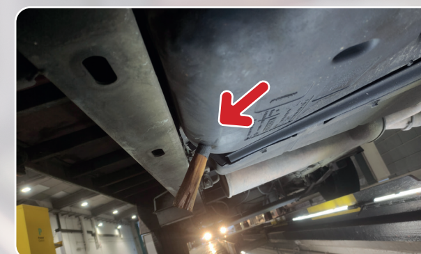
DEPÓSITO COMBUSTIBLE: Depósito con orificio tapado con un palo.
